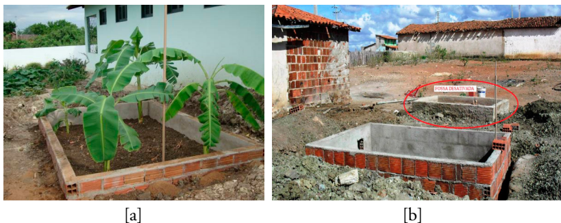
Figura 22. Módulos de Fossa Verde construídos no A25M em 2010: [a] em Posto de Saúde da comunidade Paus Branco; [b] em uma residência na comunidade de Quietão, contíguo a uma fossa antiga desativada.
